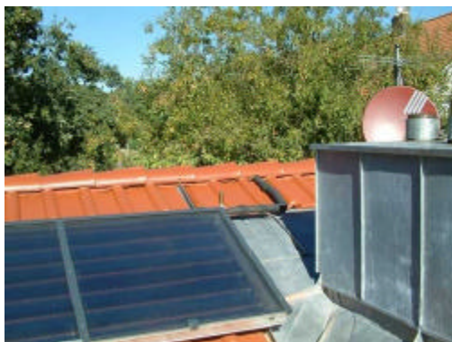
Die Kollektorenlüftung nicht an der höchsten Stelle im Solarkreis.
