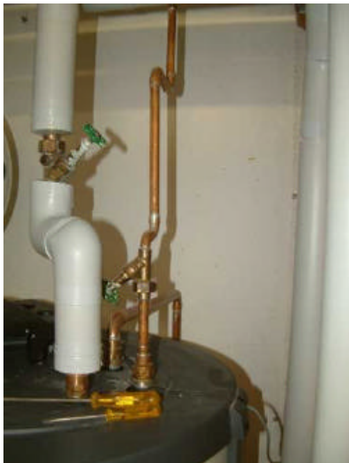
Eine ungedämmte Zirkulationsleitung, senkrecht vom Speicher abgehend.
