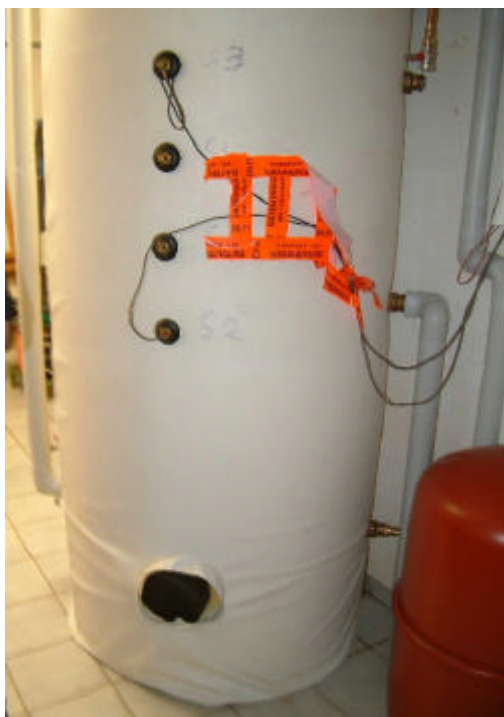
Der untere Kollektorfühler auf mittlerer Speicherhöhe angebracht.
