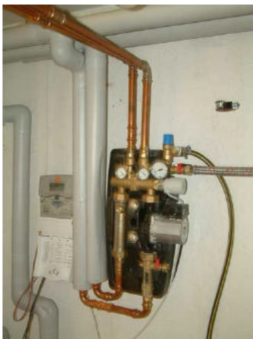
Der Solarkreis nur unzureichend wärmege dämmt.
